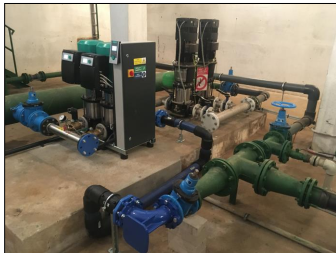
Nová AT stanice na vodojemu
