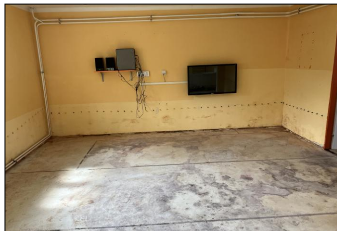
Stav podlahy ve spodní třídě v MŠ a provedené injektáže
