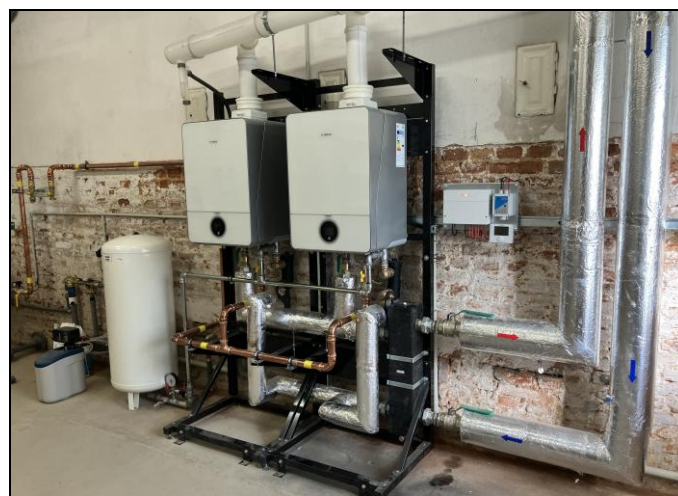
Plynová kotelná v MŠ po celkové modernizaci
