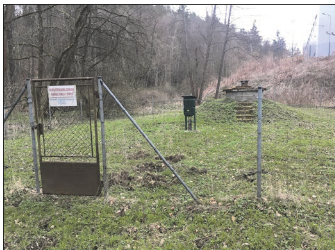
Jeden ze stávajících vodovodních vrtů na Střelnici
