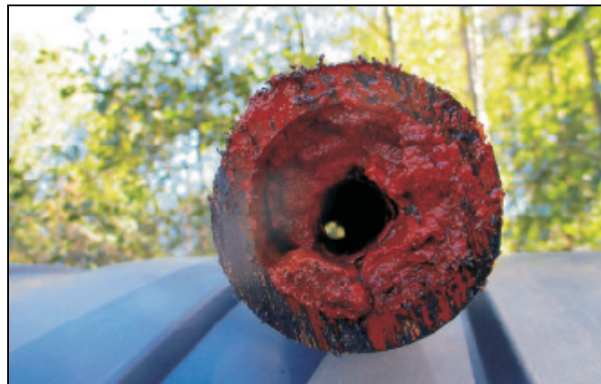
Zarostlé potrubí z vodovodního vrtu HV2 v Hamru
